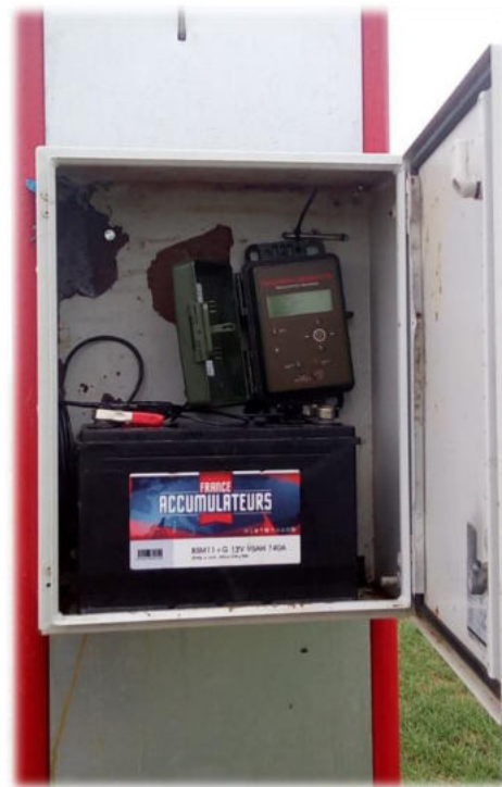
SM4BAT et sa batterie installés dans un caisson de protection en bas du mât de mesure d'Auxe (G. Marchais, Écosphère)
